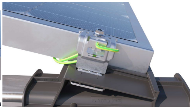
Figuur 9: Aardingsklem gemonteerd
